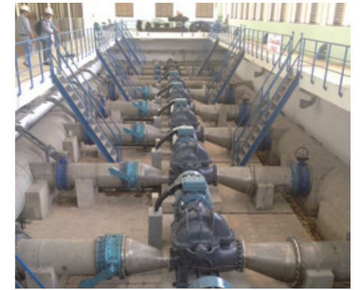
浄水場に納入した高効率省エネ型ポンプ
